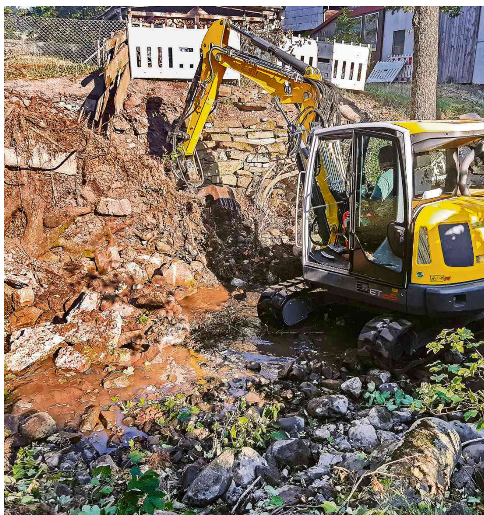
Nach einer Windhose sicherten die Verbandsmitarbeiter an der Mühle in Glattbach eine Böschung, die in die Ulster zu stürzen drohte.
